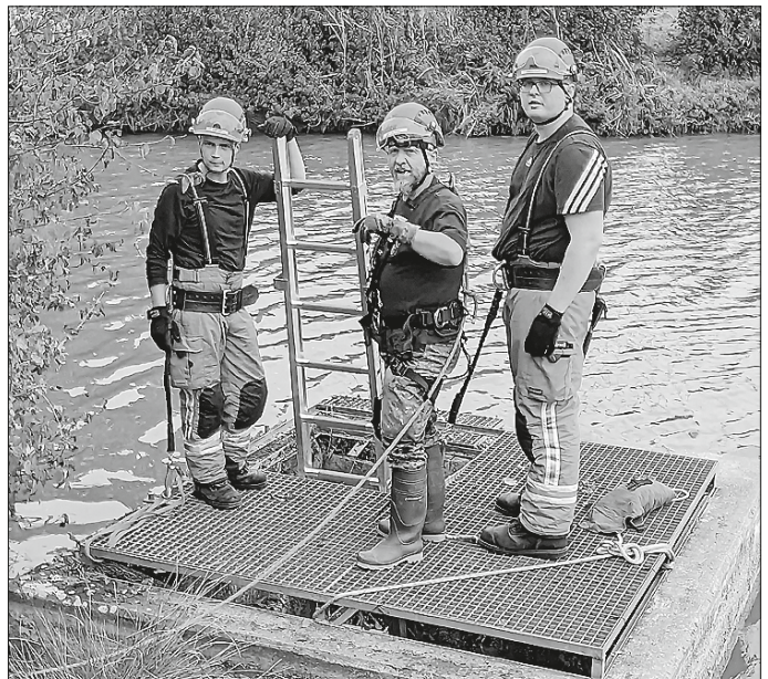
Die Gruppe der Absturzsicherung aus Kirchberg unterstützen den Fischereiverein bei Reparaturarbeiten am Mönch am Dörmnitzer See.
